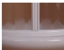
Плътнo прилепване панелите на душ-кабината към поддушовото корито
