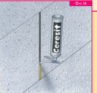
Фуги, по-големи от 2 mm и недобре уплътнени участъци трябва да се запълнят с полистирен или полиуретанова пяна. Пяната увеличава своя обем при употреба, затова трябва да се нанася повърхностно във фугите между плоскостите. Излишното количество пяна се отстранява с нож. Фугите не се запълват с циментов разтвор, за да се избегне образуването на термомостове.
