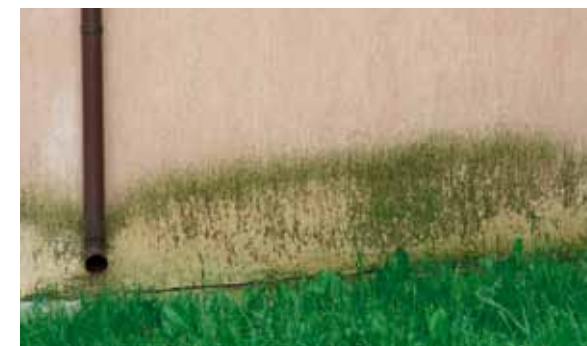
Фасадата с обикновена мазилка не е защитена от мухъл и плесен.
